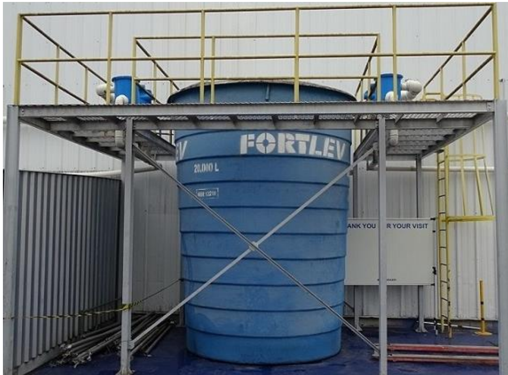
Figura 3 - Tanque de Armazenamento da água de reuso e de água da chuva.
