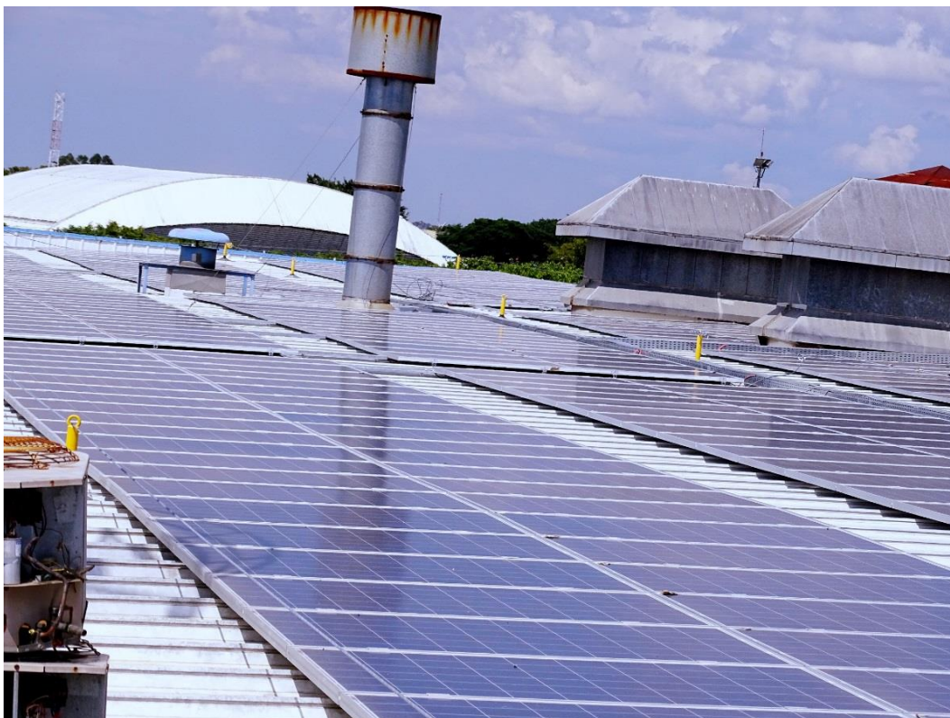
Figura 4 – Painéis fotovoltaicos na cobertura do prédio F-210.
