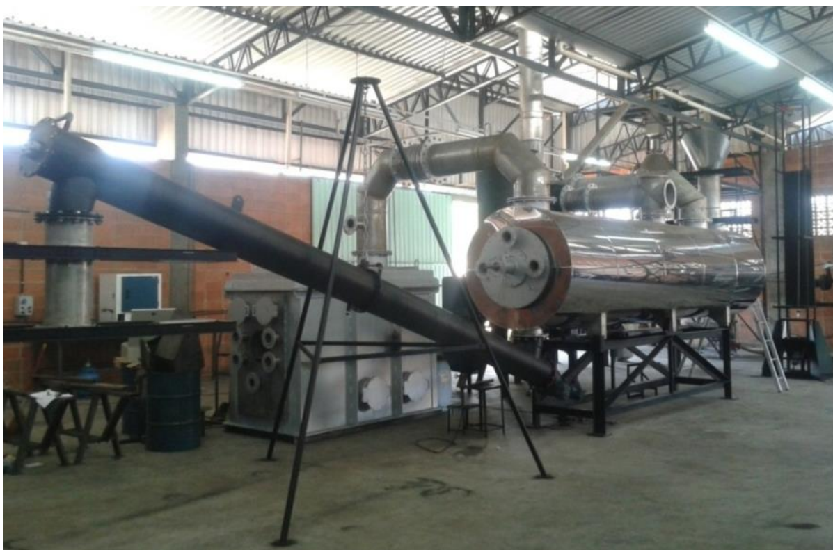
Figura 4 – Planta de Processamento de Pneus Inservíveis da SP - 10 t/dia
