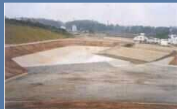
Reservatório AT3 Petrobrás Tamanduateí - Mauá
