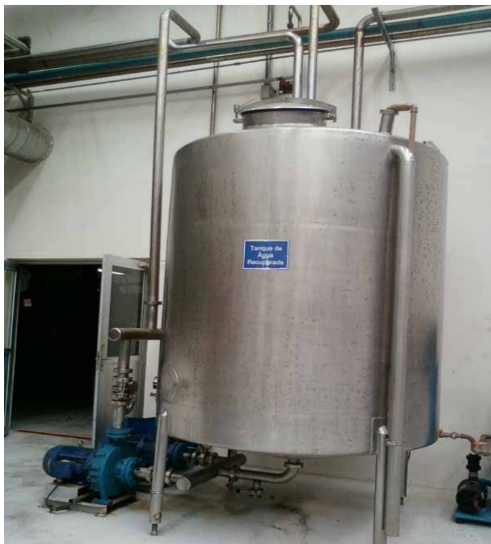
Sistema de reaproveitamento de água do rinser de garrafas PET
