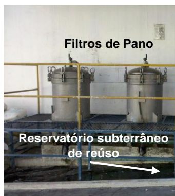
Sistema de filtragem de água para reúso
