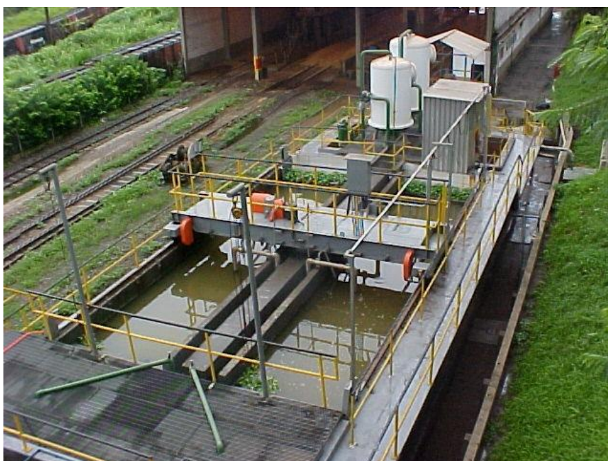
Figura 2: Vista da Unidade de Tratamento de Efluentes: Empresa, 2009.
