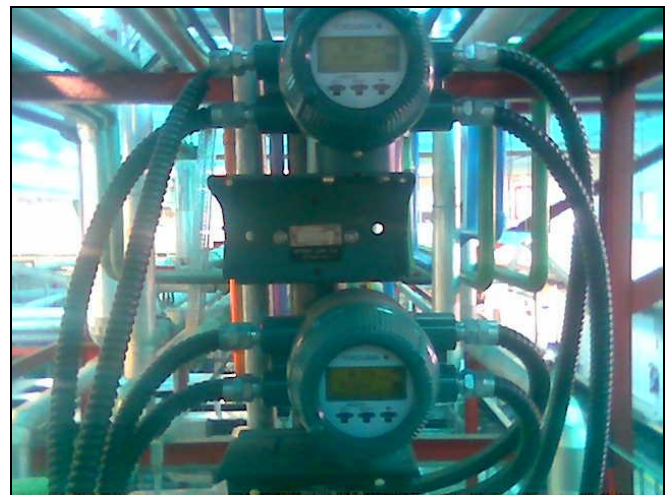
Figura 2 : Medidor de Vazão das linhas de envazamento 502 e 503
