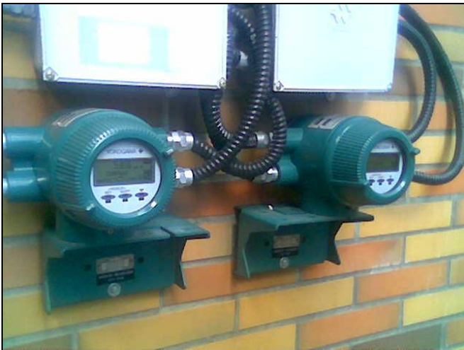
Figura 1: Medidor de Vazão da área de Adega e da Filtração
